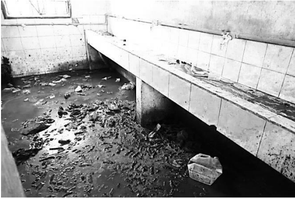
Banheiro de um centro de detenção em Misrata (Líbia) inundado de fezes e urina. TANKRED STOEBE MSF
